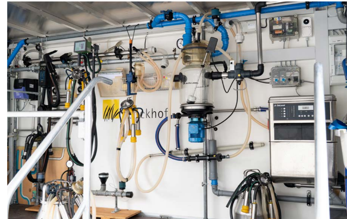
Funktionsfähige Melkanlage und Aggregate verschiedener Hersteller.
